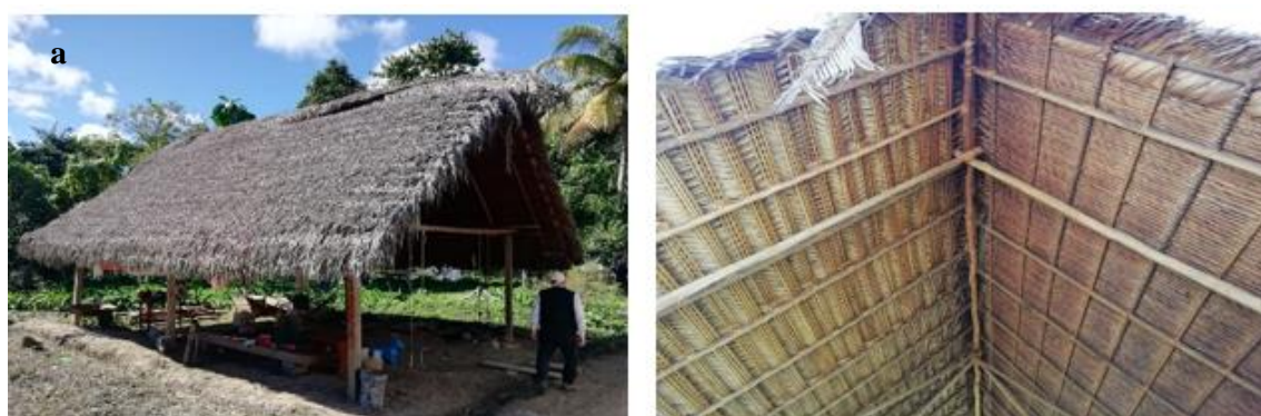
Figura 6. Cobertura terminada (a); Interior de la cobertura con yarina y palmiche (b)
